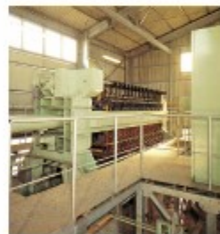
廃水処理設備 フィルタープレス
