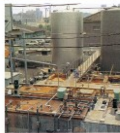
本社工場の廃水処理設備
